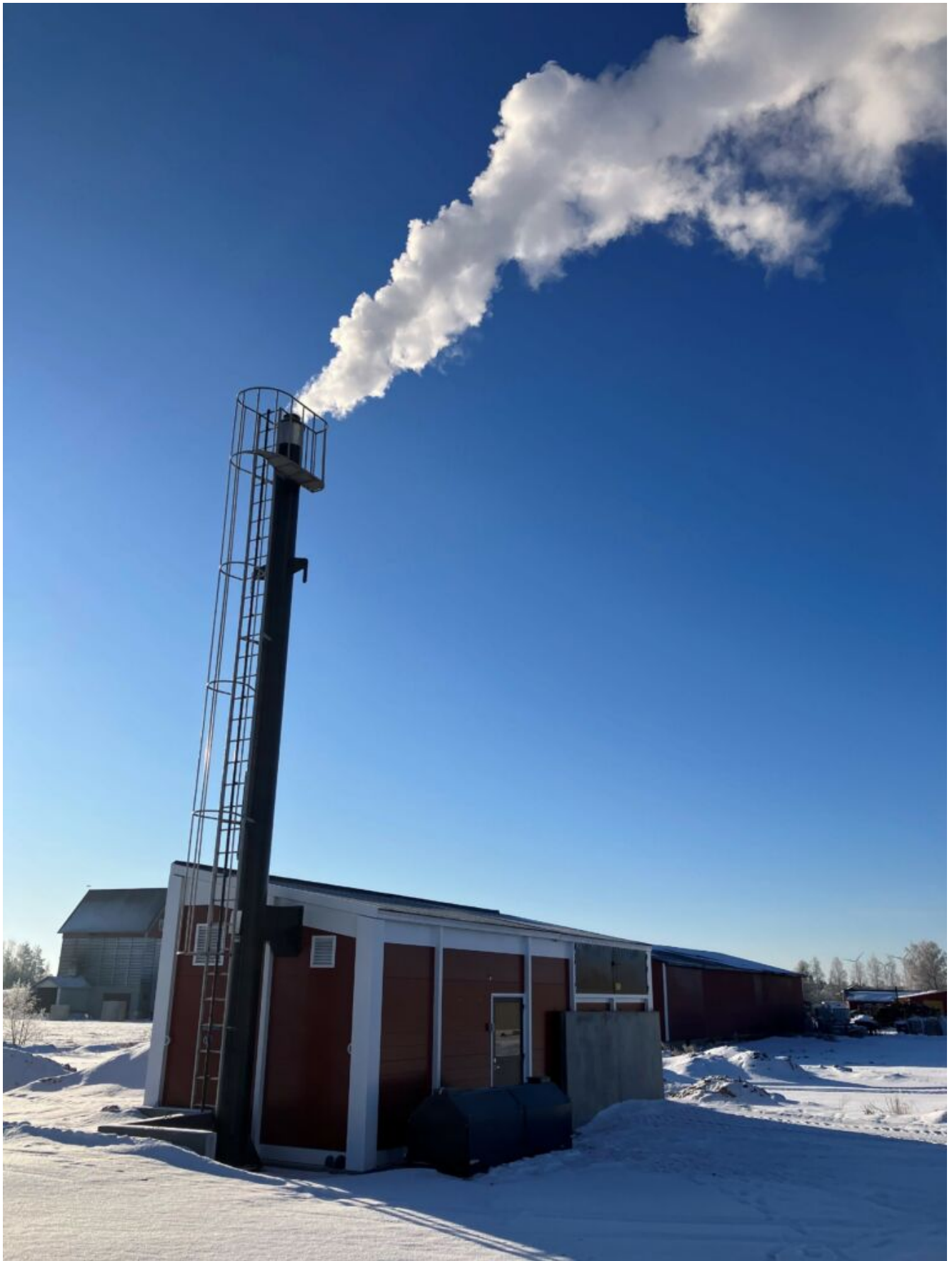
Tuorehakkeella ja kuivatulla hankkeella toimiva lämpökeskus (500 kW) talviasussa Katteluksen broileritilalla Lapualla. Veljekset Ala-Talkkari Oy rakensi laitoksen (kuva: Risto Lauhanen).
