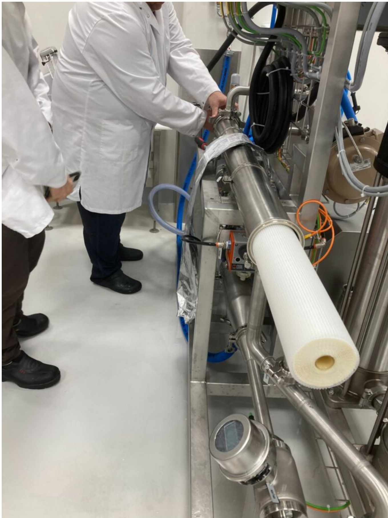
Kuva 2. Membraanisuodatuslaitteiston suodatusyksikkö ja spiraalimembraani (kuva: Alisa Ala-Huikka, 2024).
